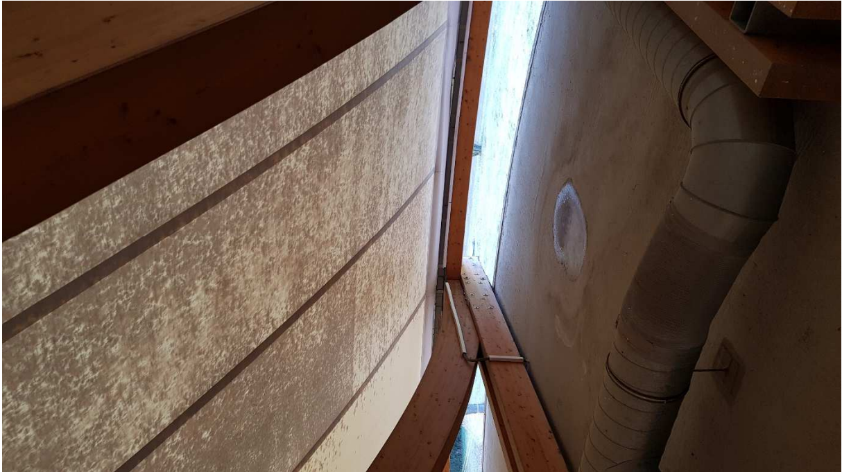
Detailuntersicht Westseite (Stockflecken durch Algenbefall)
