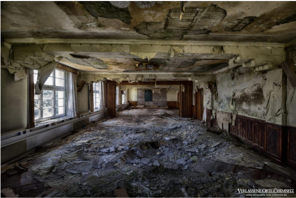
Foto mit Schadensbild vom August 2015
